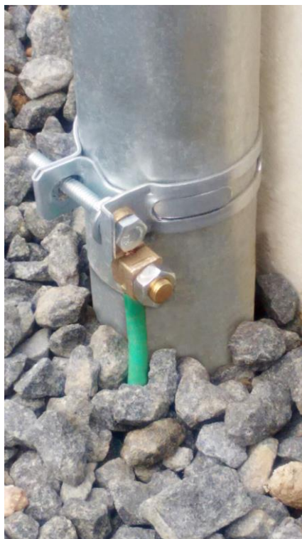
Foto ilustrativa 02 dos anexos D,E, H e I – Detalhe da abraçadeira de com terminal para aterramento
